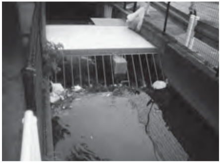
ごみなどの堆積で、増水した様子
