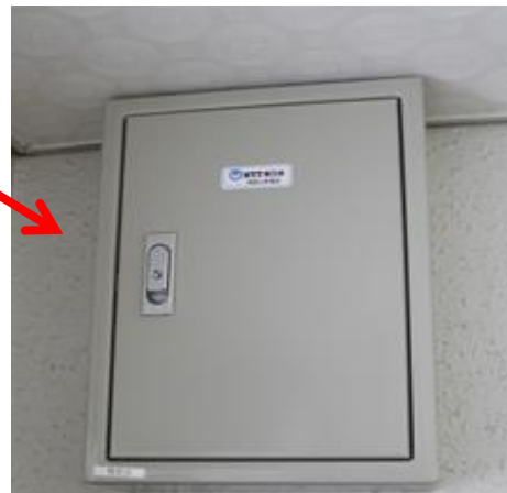
電話接続端子盤
