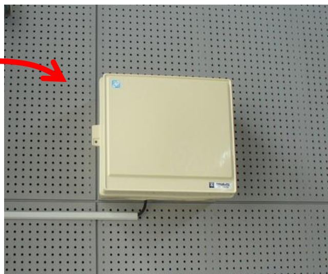
MCA無線機 アンテナケーブル
