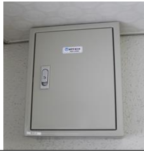
電話接続端子盤
