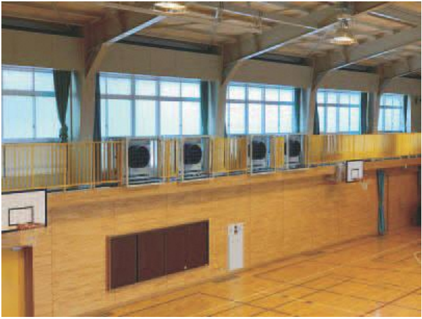
稲城市立小・中学校体育館の空調設備 (稲城第六小学校)
