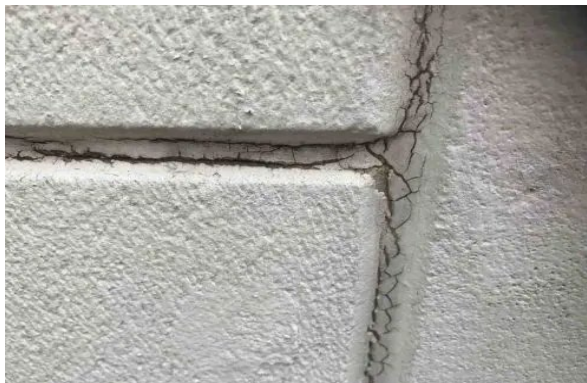
シーリング材の劣化（割れ）
