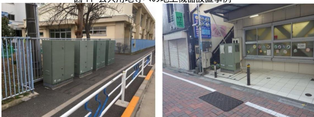
図 11 公共用地等への地上機器設置事例
