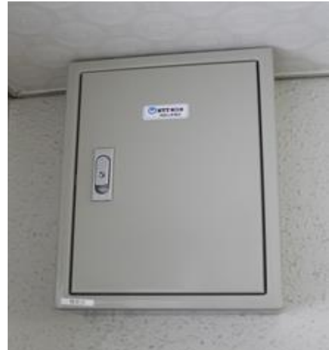
電話接続端子盤
