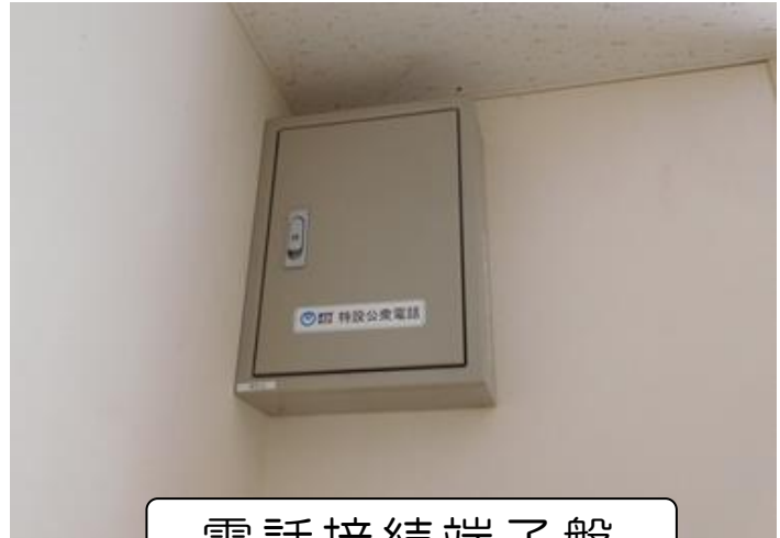
電話接続端子盤
