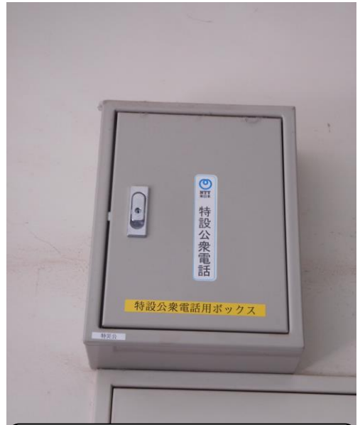
電話接続端子盤
