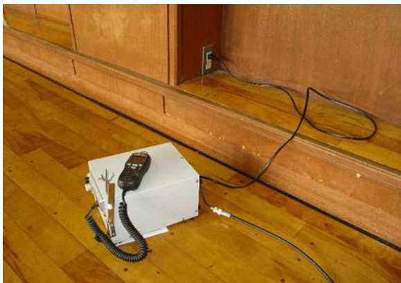
コンセント接続の例
