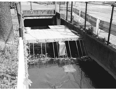
▲ごみなどの堆積で増水した様子
