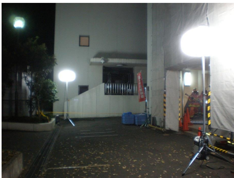
※消防署玄関前の仮設照明
