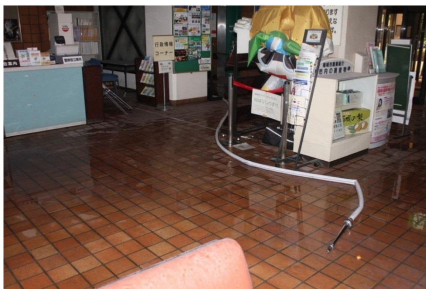
※消火活動後の様子
